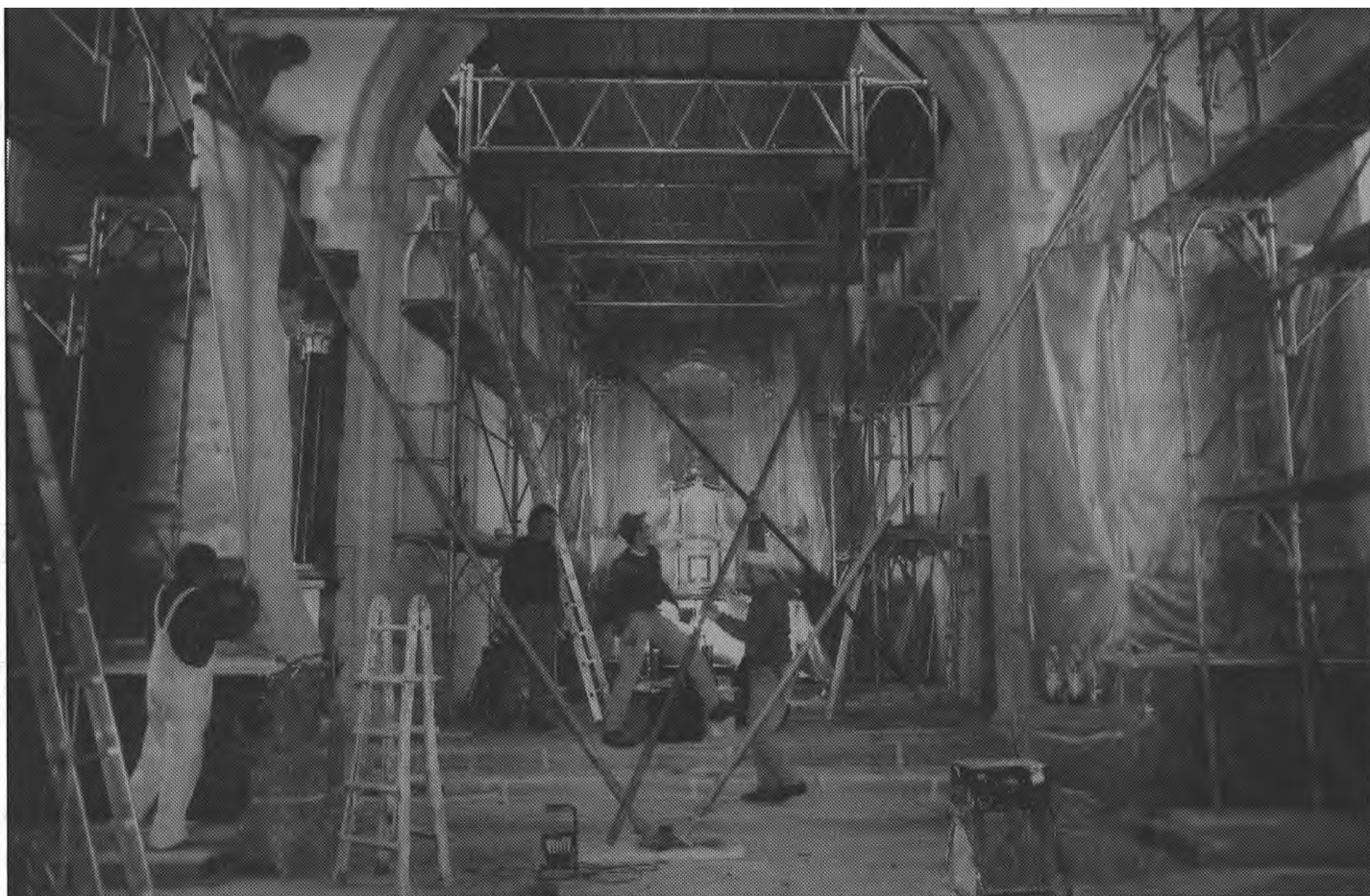
Das Innere der Pfarrkirche von Plasselb ist momentan eine grosse Baustelle. Die Schäden durch die defekte Heizung machen eine gesamte Renovation des Innenraums nötig. (Fotos: Charles Ellena)
